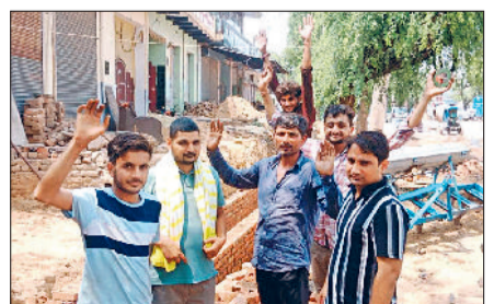
मंडी अटेली। अनियमितताओं के विरुद्ध रोष जताते ग्रामीण। निर्माण कार्य किया जा रहा है। नाले के निर्माण में घटिया सामग्री का प्रयोग किया जा रहा है।
